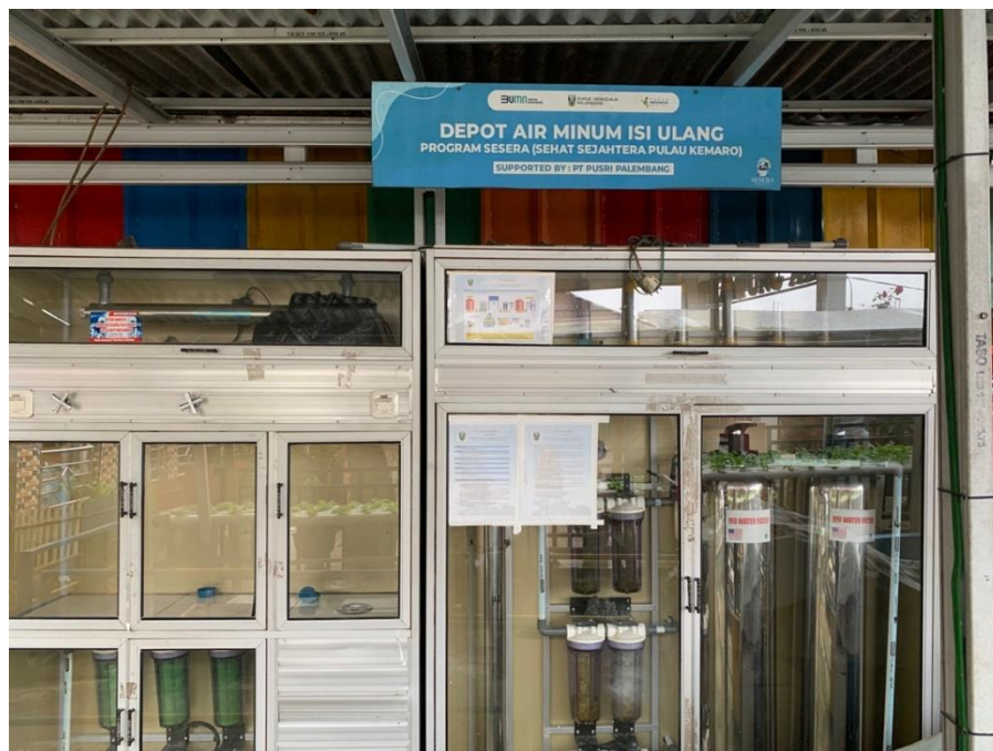
Gambar 3.15 Instalasi Pengolahan Air Minum
