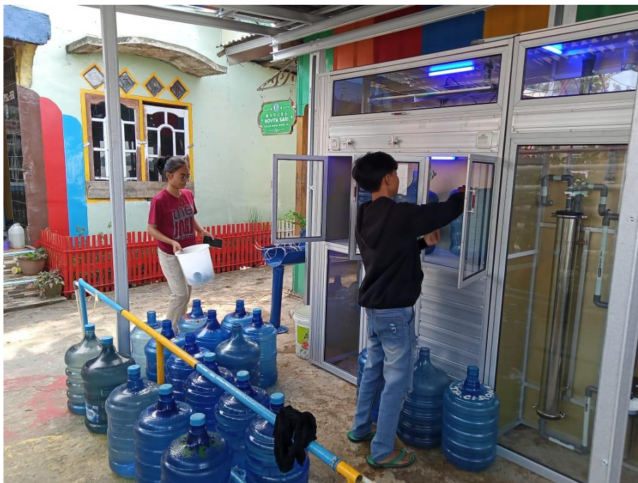
Gambar 5.14 Instalasi Pengolahan Air Minum
