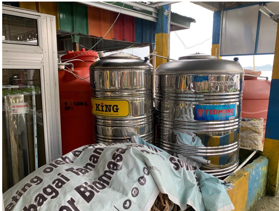
Gambar 3.9 Instalasi Air Bersih
